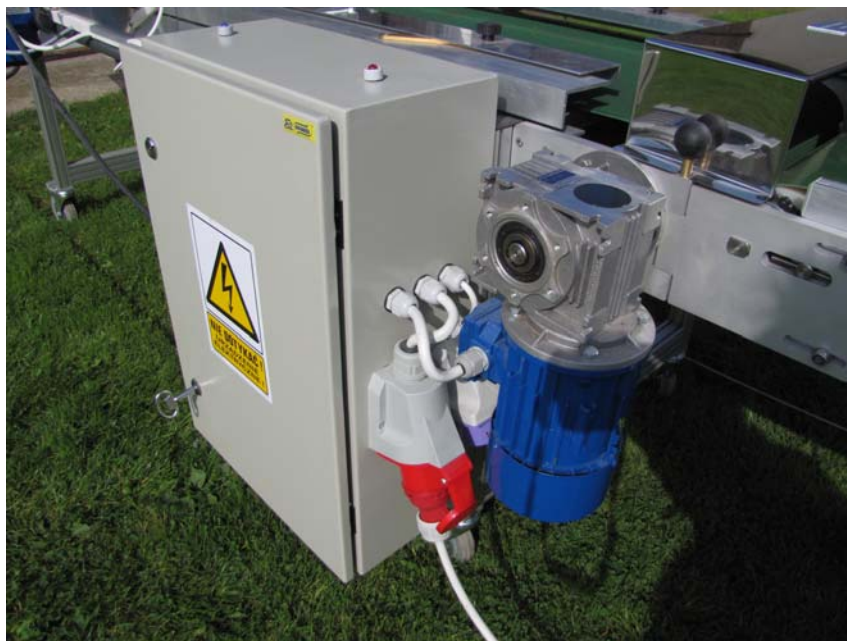
Skrzynia sterownicza z boku widoczne gniazda podłączeń modułów, z góry lampki sygnalizacyjne.
