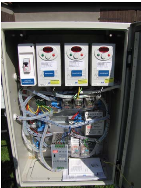
Skrzynka sterownicza z trzema falownikami, z lewej widoczny bezpiecznik linii.
