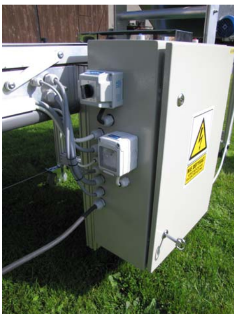
Skrzynia sterownicza ,widoczne gniazdo pompy powietrza oraz wyłącznik główny
