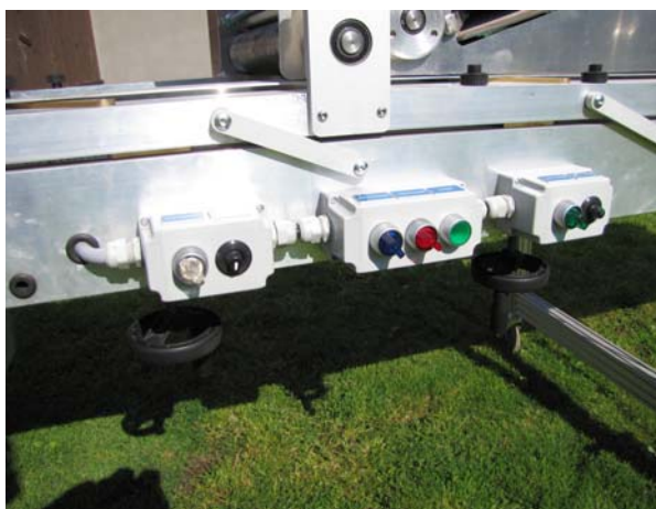
Kasety sterownicze z wyłącznikami i potencjometrami
