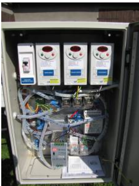
Шафа управління з трьома інверторами, зліва - запобіжник лінії.
