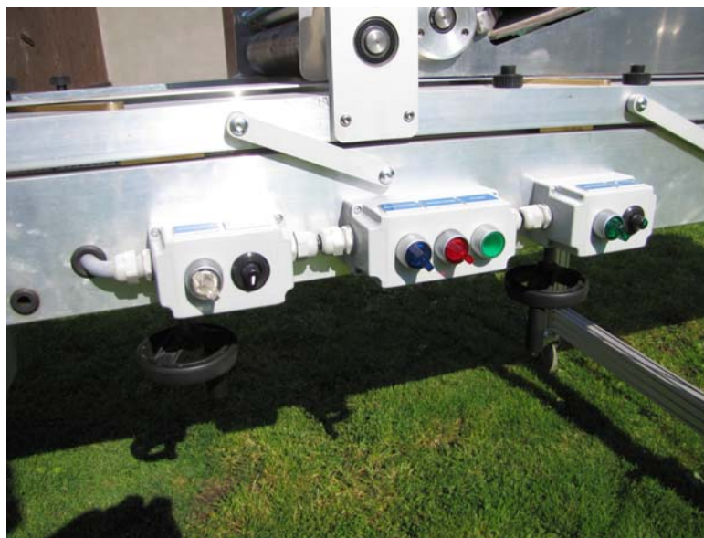
Kasety sterownicze z wyłącznikami i potencjometrami
